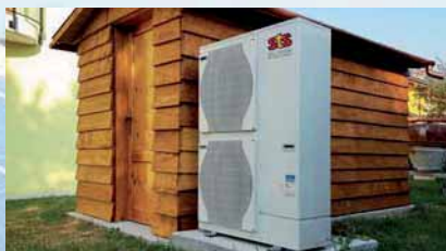
Impianti pompa di calore
